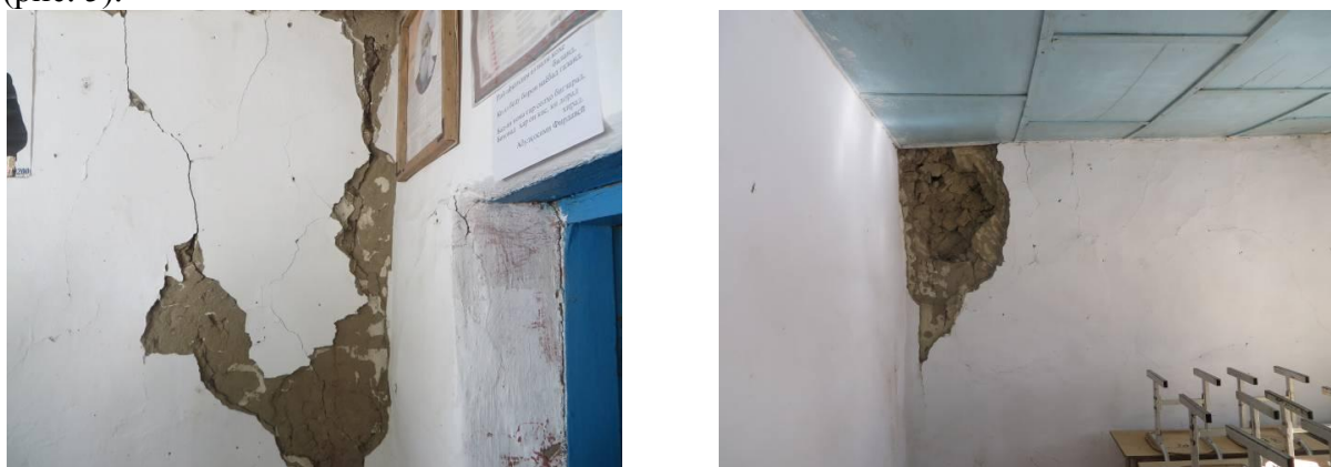
Рис.5. Трещины в пересечении стен (угловые части)
