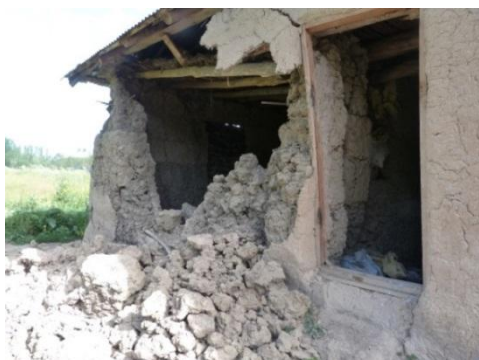
Рис. 4. Повреждение нового жилого дома
