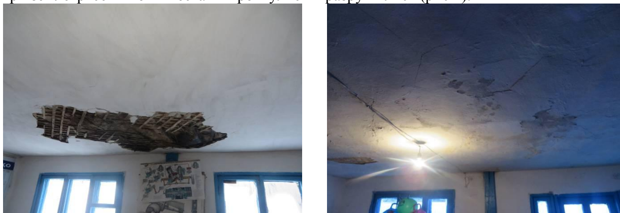
Рис.4 Состояние потолков, оштукатуренных по «дранке»
