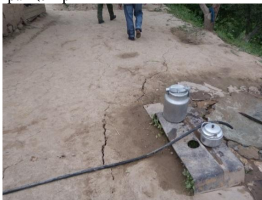
Рис.7. Трещины на поверхности земли
