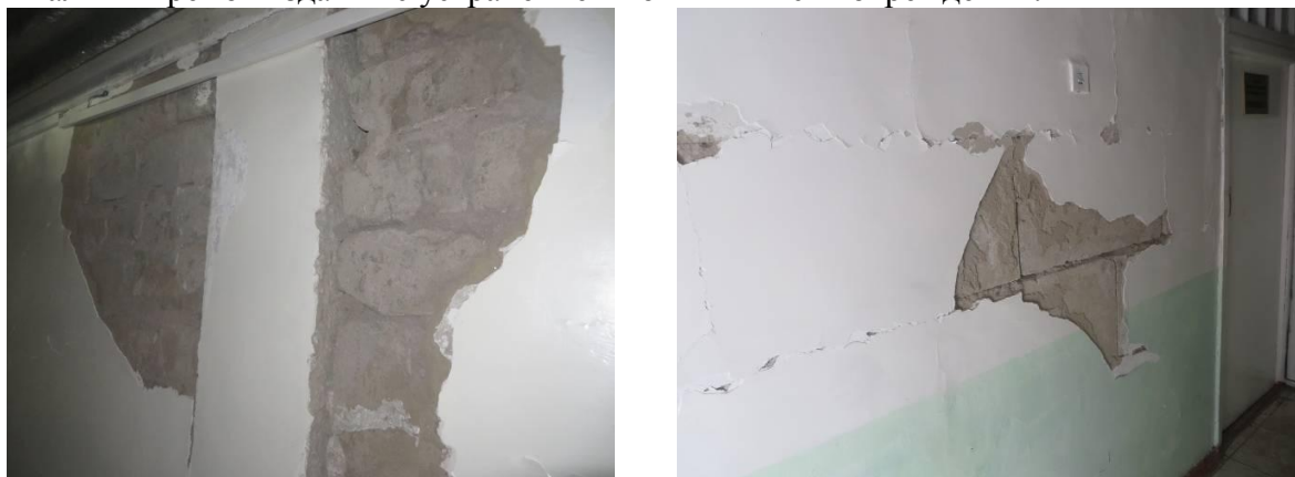
Рис.2 Оконтуривание заполнения основного каркаса здания и отслоение штукатурных слоев
