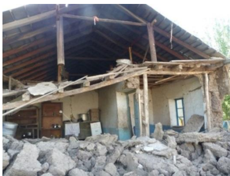
Рис. 5. Обрушение части крыши и стен жилого дома
