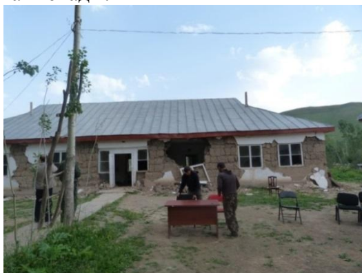
Рис.2. Повреждение здания школы № 65.
