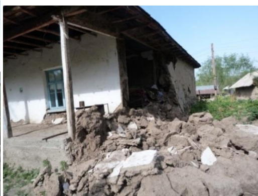
Рис.3. Обрушение части стены жилого дома
