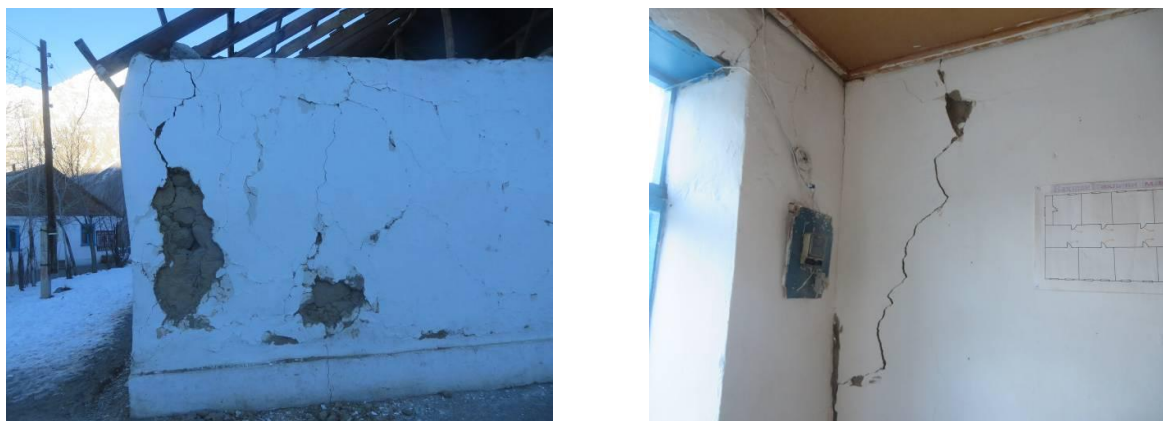
Рис.3 Трещины в пересечении стен (угловые части)
